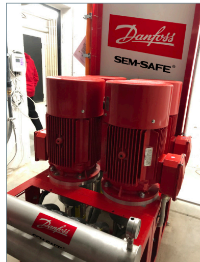
Unidad de bomba de alta presión compacta SEM-SAFE® instalada en SKAIO.
